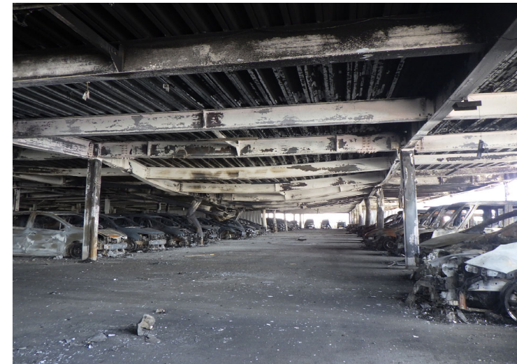
<建物内部（火災後）>
