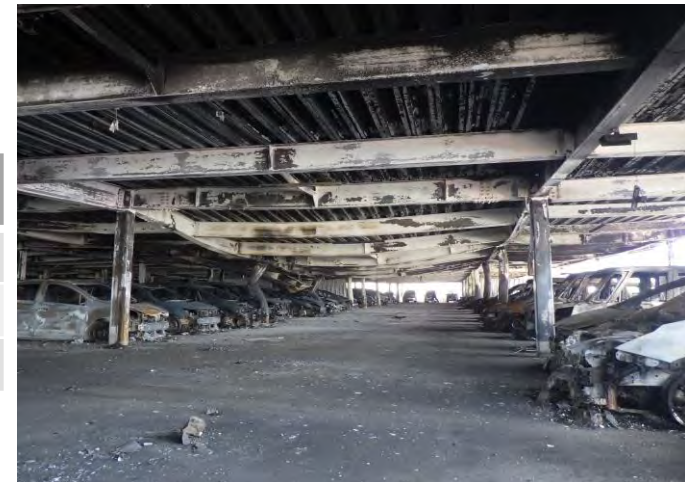
<建物内部（火災後）>
