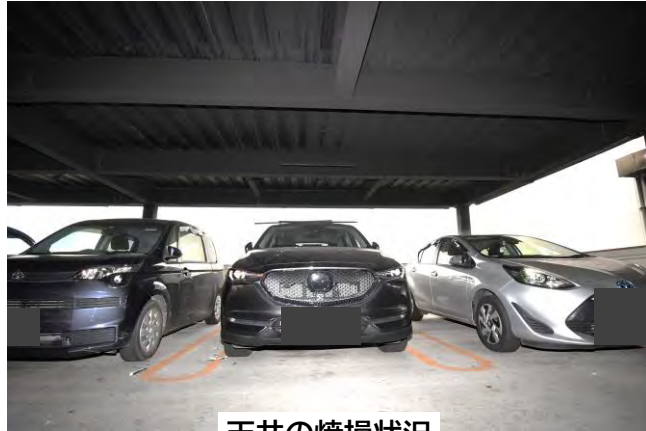
天井の焼損状況
