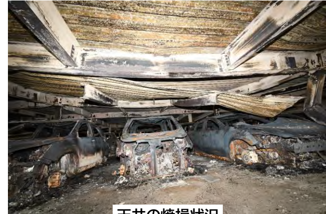
天井の焼損状況
