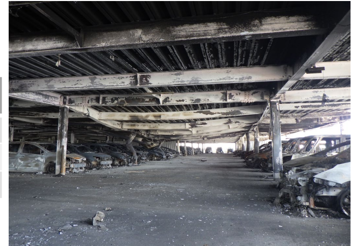
<建物内部（火災後）>
