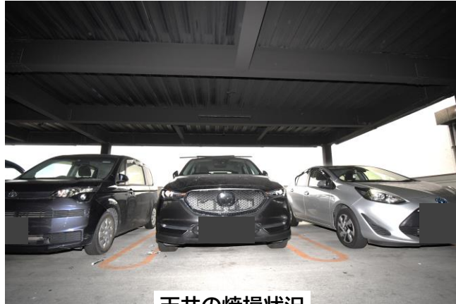
天井の焼損状況
