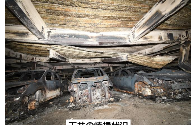
天井の焼損状況
