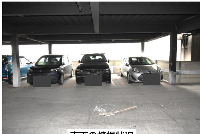
車両の焼損状況
