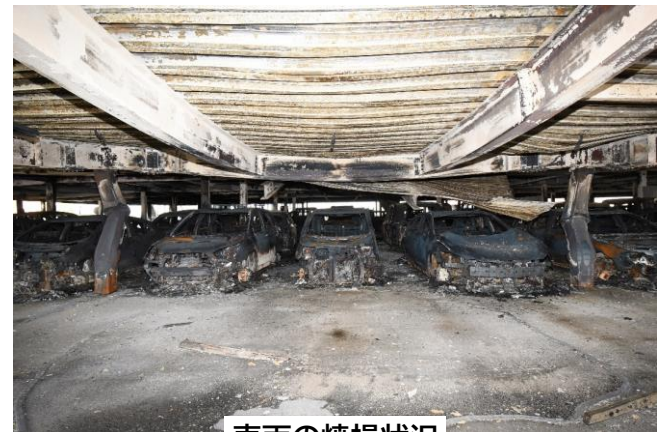
車両の焼損状況
