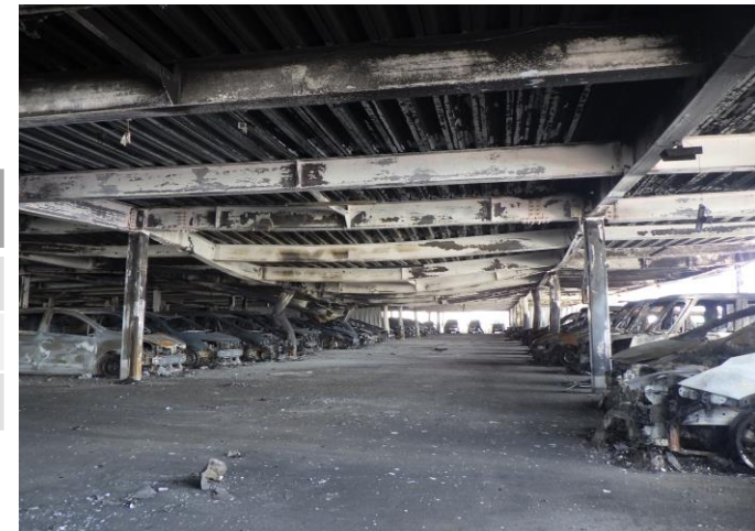
<建物内部（火災後）>
