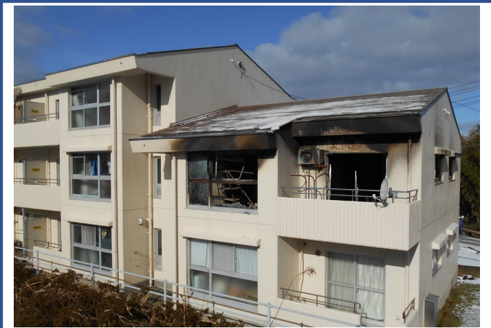
図5 <No. 15> 出火建物の様子（火災後）
