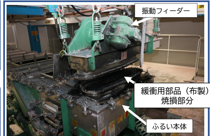
図1 <No.1> 篩過工程の焼損の様子（火災後）
