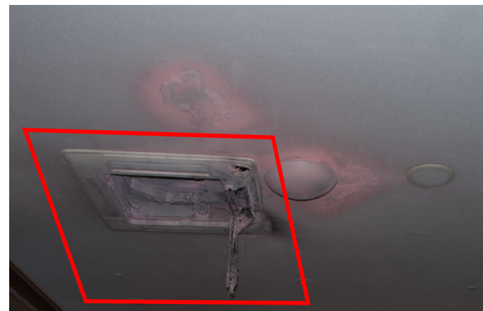
図2 <No. 5> 出火箇所（エアコン室内機）の様子（火災後）
