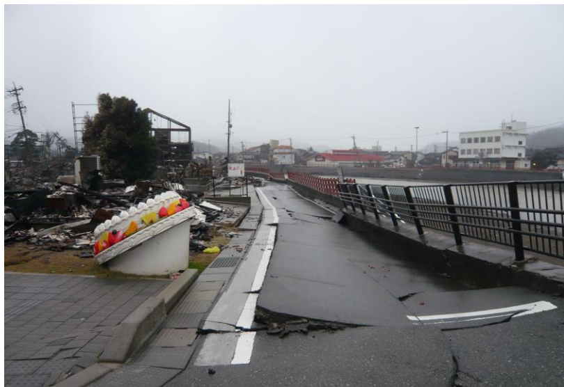
河原田川沿いの道路の隆起と護岸外壁の傾斜
