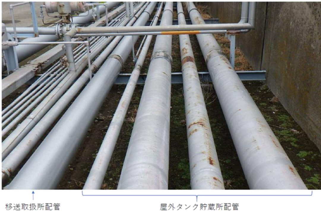
図 2-3-5 事業所内の配管設置例
