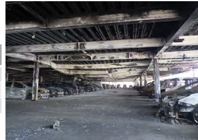
<建物内部（火災後）>
