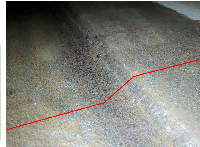
やや腐食した溶接表面
