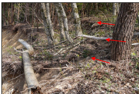
(地すべり斜面上部の亀裂)
