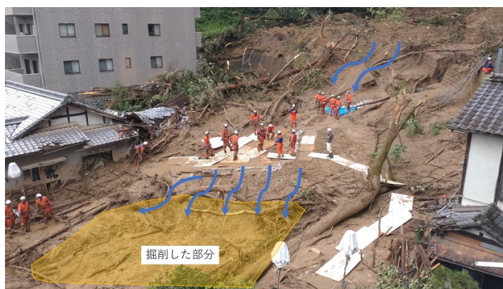
【雨水流れ込みによる堆積土砂の軟化状況】
