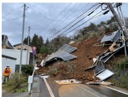
【土砂流出状況】
