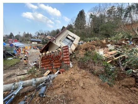
【建物 B 倒壊状況】
