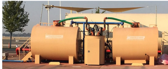
延焼防止剤の保管・混合装置
