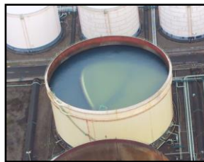
浮き屋根油没
