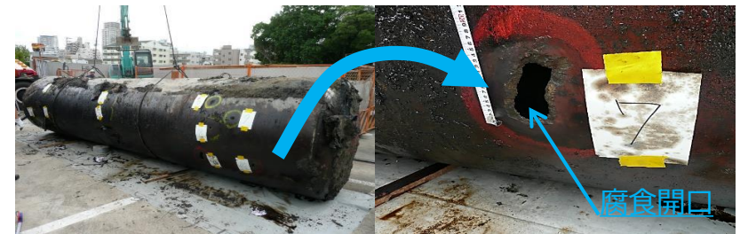
地下タンクに腐食による開口が生じて貯蔵油が流出した事故事例
