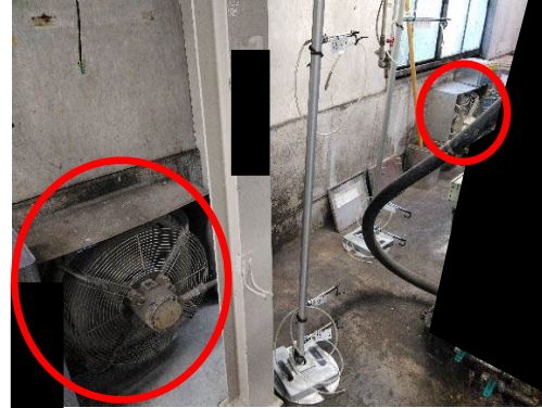
自動強制換気設備による換気状況
