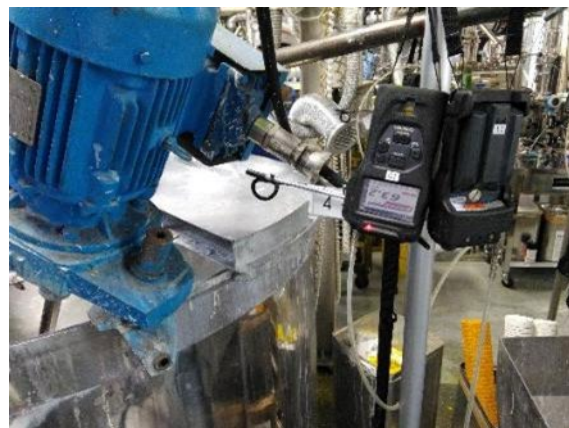
釜直近設置する可燃性ガス検知器の発報状況
