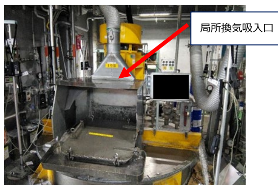
ニス作業場における原料投入口上部の局所換気設備
