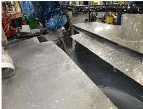
【図43 配管からの原料危険物の投入状況】
