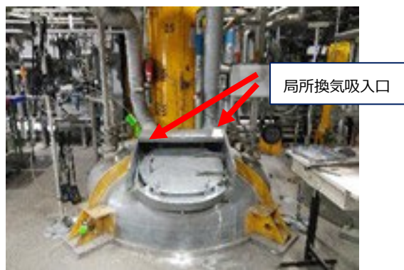
コーチング作業場における原料投入口上部の局所換気設備
