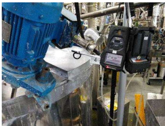
【図44 釜直近右手奥（高さ130cm）の検知器の発報状況】
