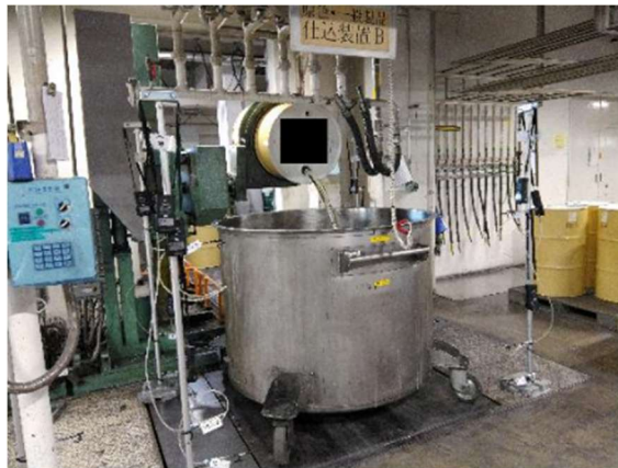
【図 34 ドラムからの原料危険物の投入状況】
