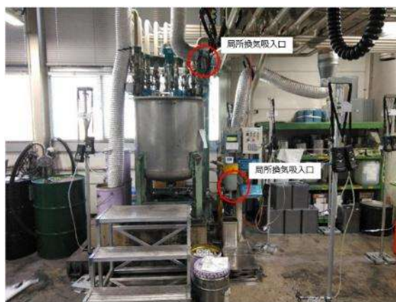
【図 35 容器充填設備 換気状況】
