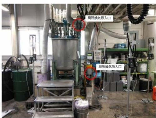
容器充填設備 換気状況
