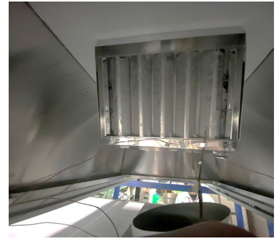
グリスフィルター設置状況
