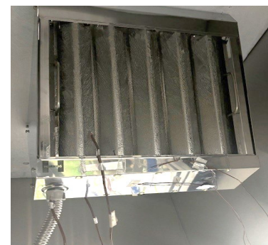
実験後のグリスフィルター
