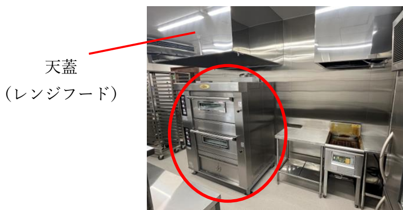
写真1 厨房に設置されているデッキオーブン
