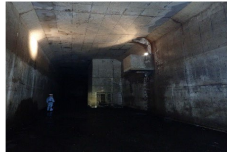
【雨水調整池内部】
