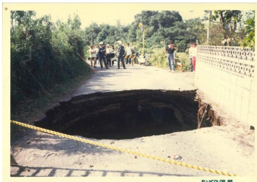
【陥没した穴の全景】
