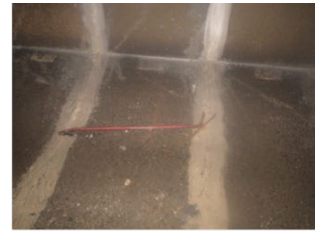
雨水管内部の残置された工具
