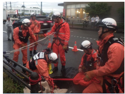
【雨水管内の侵入状況】
