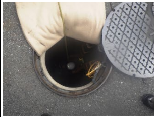
雨水マンホール（進入口）
