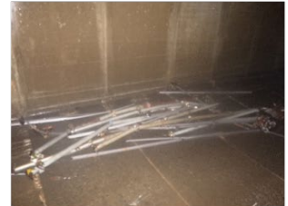
雨水管内部の破損した流れ止め
