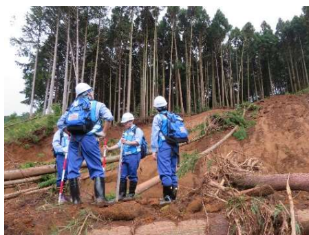
被災状況調査班による 崩落箇所調査
