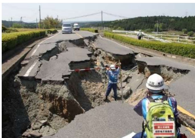
道路被害状況の調査
