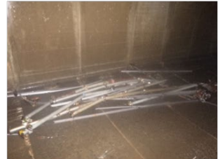
雨水管内部の破損した流れ止め
