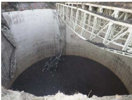
【鉄製トラスの状況】
