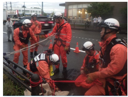
【雨水管内の侵入状況】
