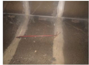
雨水管内部の残置された工具
