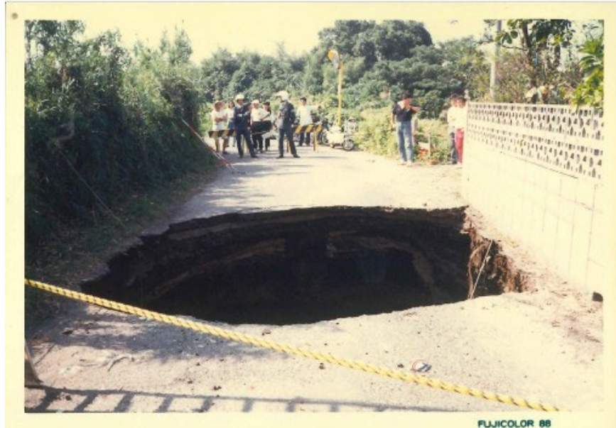
【陥没した穴の全景】
