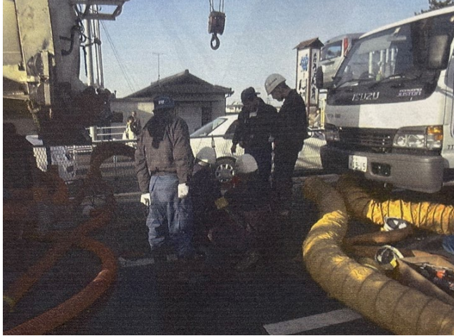
【クレーン付きトラックのクレーンを引き揚げ用に使用】
