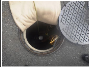
雨水マンホール（進入口）
