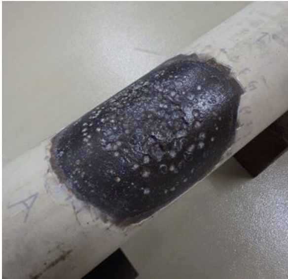
図 5-11 配管の腐食状況 (写真)
