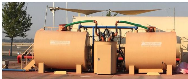
延焼抑制剤の保管・混合装置
