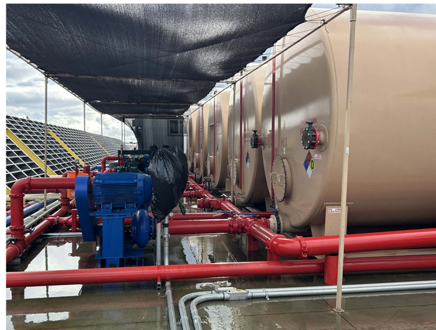
リターダントの保管タンク及び 機体供給用ポンプ
