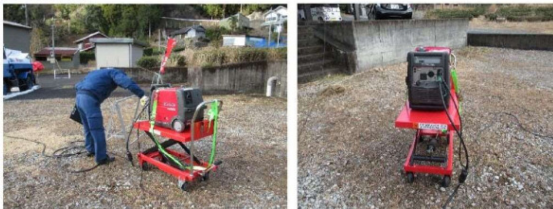
発電機は、しっかりした土台の上に置き、高さ60cm以上の高さを確保
