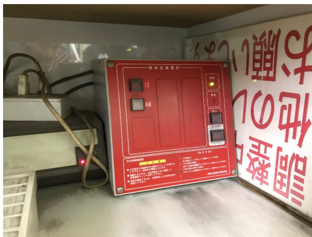
泡消火設備起動ボタン
