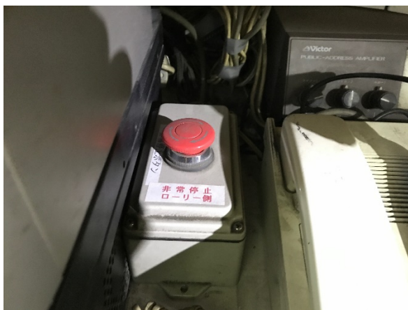
非常停止ボタン
