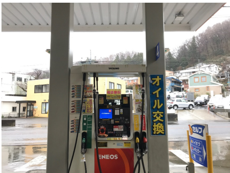
固定給油設備 3・4 レーン (正面)
