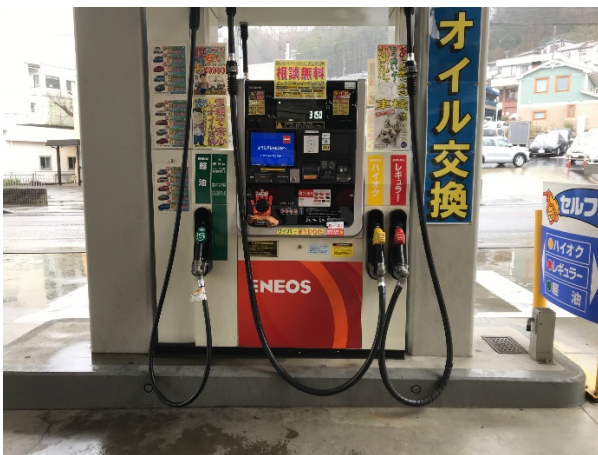
パッケージ型泡消火設備①
