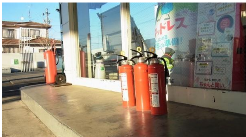
消火設備（消火器）
