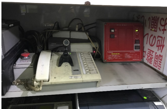
泡消火設備起動ボタン等（全体）
