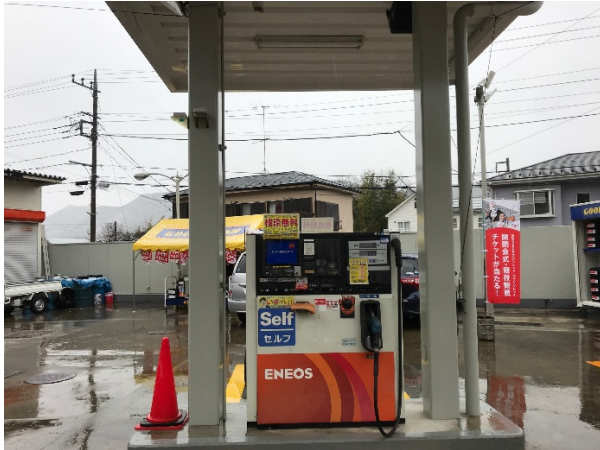
固定注油設備 5・6レーン（正面）
