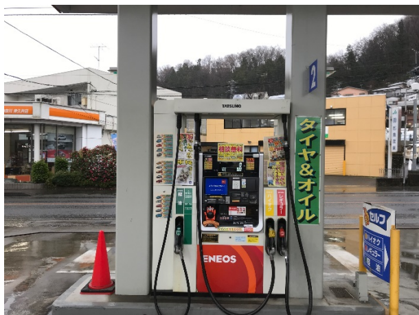
固定給油設備 1・2 レーン（正面）
