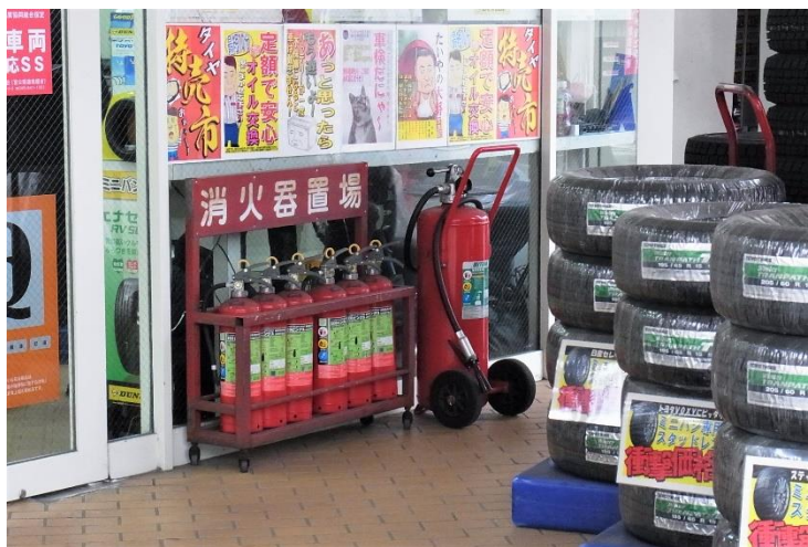
消火設備（消火器）
