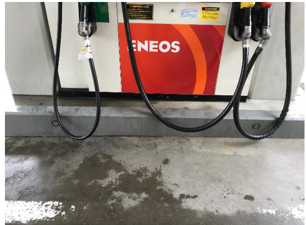
パッケージ型泡消火設備②
