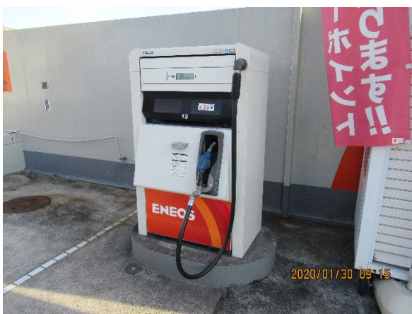
写真5 固定式注油設備（灯油）
