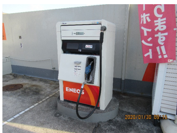
写真 5 固定式注油設備（灯油）
