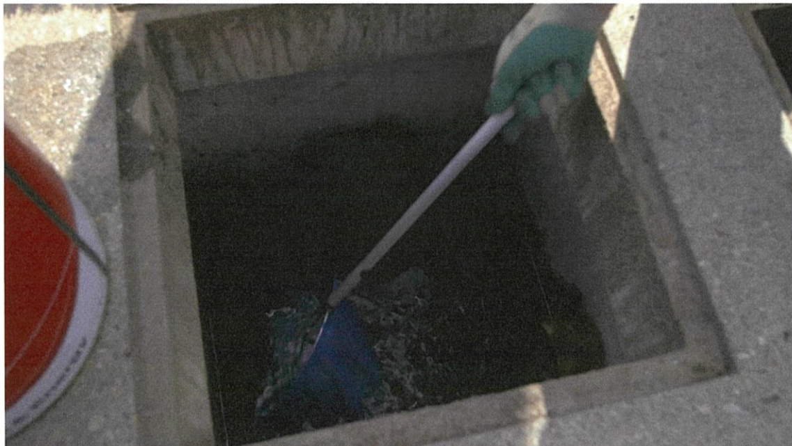
油分離槽内のごみはこまめに清掃する。
