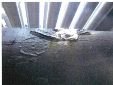
上部から雨水が垂れ腐食した例
