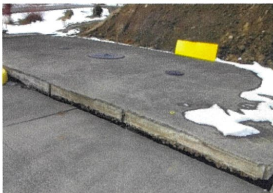
地下貯蔵タンクが液状化で隆起した例
