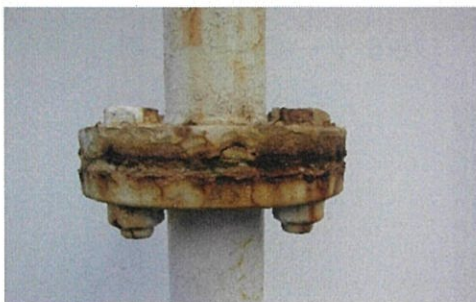
垂直フランジ上部は腐食しやすい
