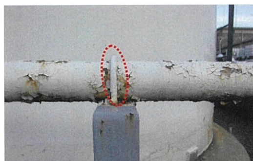
U ボルトは水が溜まり腐食しやすい
