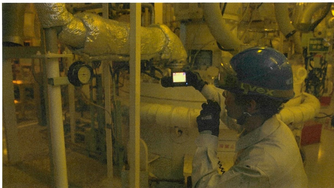
計器、サーモカメラによる確認。各表示に違いがないか確認。
