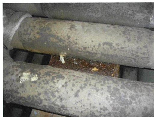
防食措置の劣化がみられる
