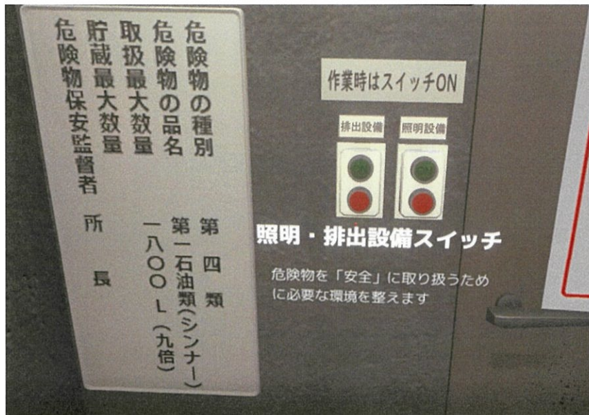
図6 照明設備及び排出設備のスイッチ
