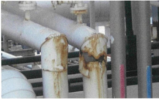
保温材が損傷している例
