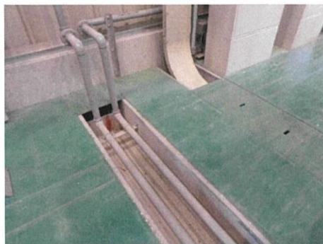
配管ピット（屋内）
