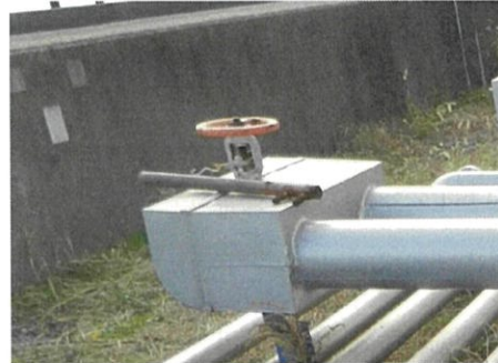
フランジ、バルブの根元部分の保温材の外装施工がしにくい所は、雨水が侵入しやすい
