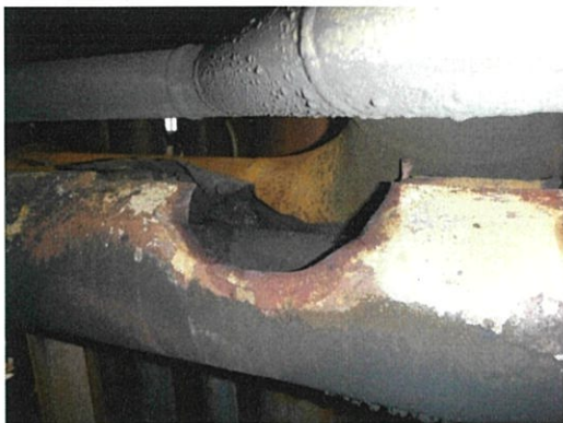
保温材（板金）の切り欠きは雨水が侵入する
