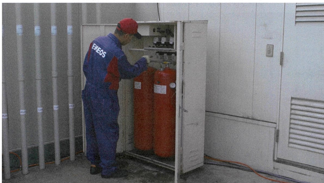
セルフスタンドの泡消火剤の確認。
