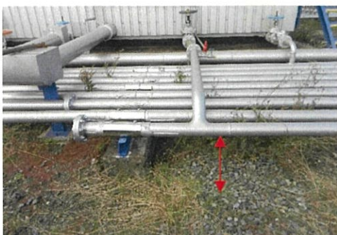
地面との離隔がない例
