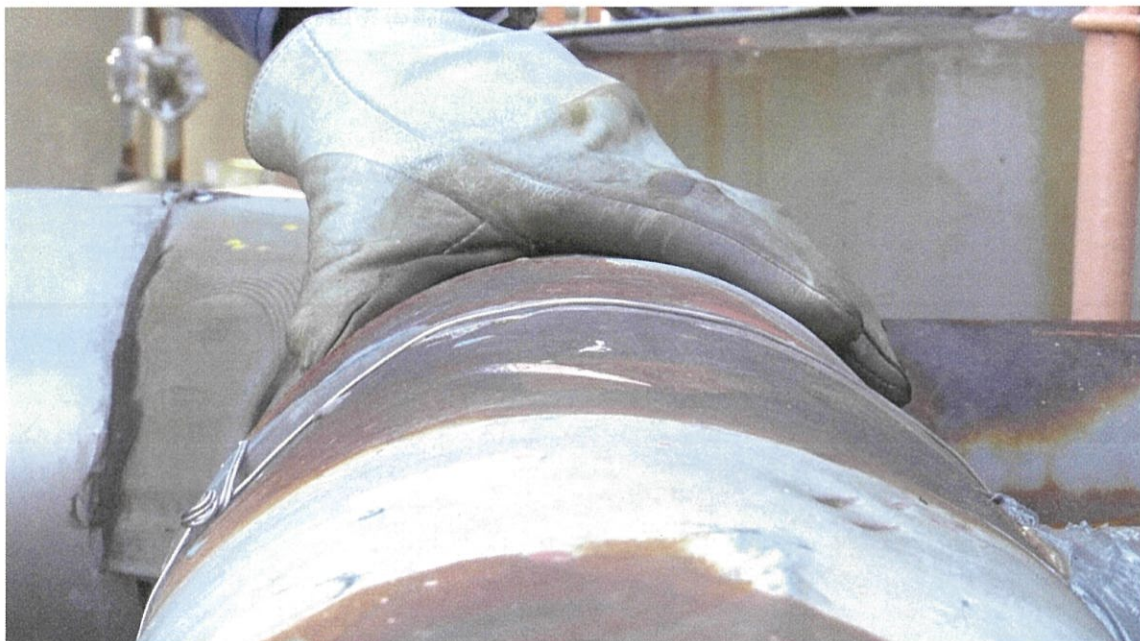
保温材に膨れや凹み等がないか。
