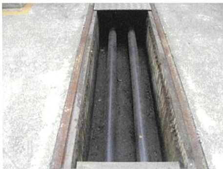
配管ピット（屋外）
