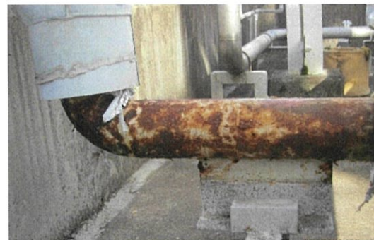
保温材（板金）をはがした後、防水措置をせず保温材を巻いたため腐食した事例がある。
