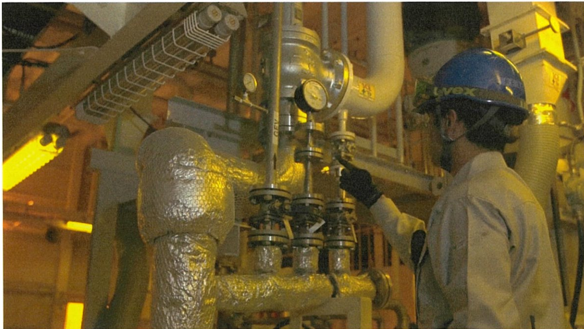
計器の指示部、取り付け状態を確認。
