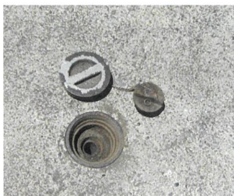
実際の漏えい検査管
