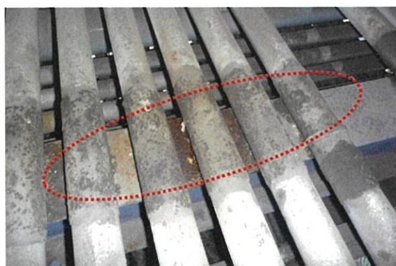
サポート接触部は水が溜まり腐食しやすい
