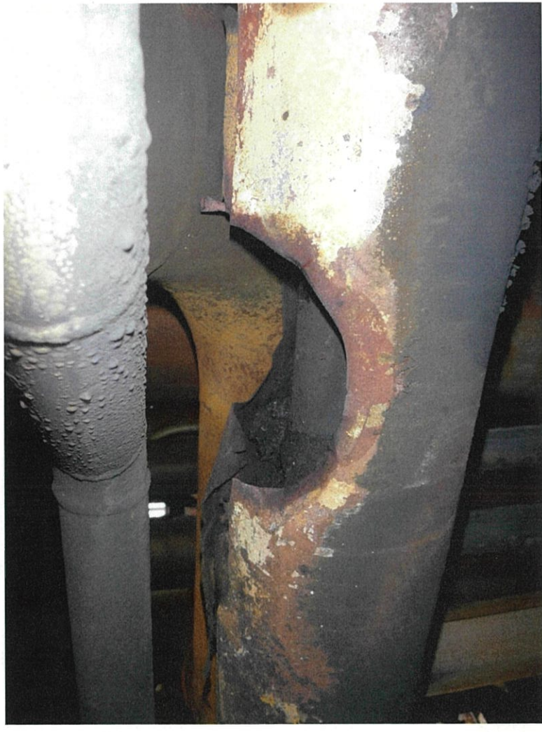
保温材(板金)の切り欠きは雨水侵入
