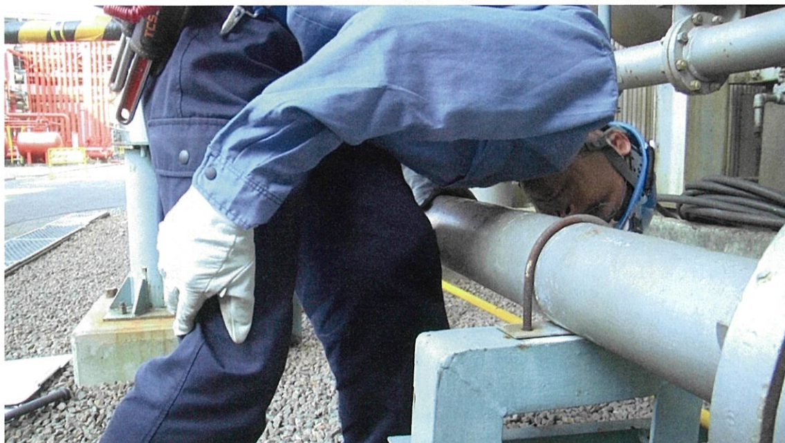
配管サポートやUバンドの接触部は、雨水が溜まり腐食しやすい。
