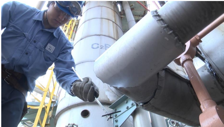
保温材外装板の施工しにくい箇所は、隙間が出来やすく、雨水が入りやすい。
