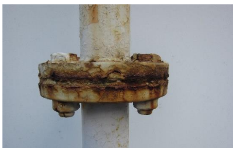
垂直フランジ上部は腐食しやすい
