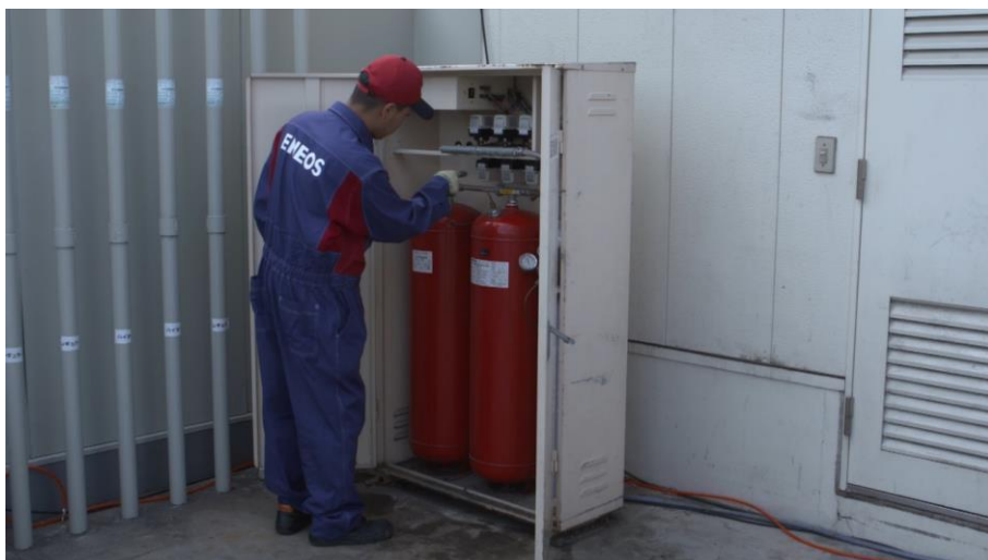
セルフスタンドの泡消火剤の確認。
