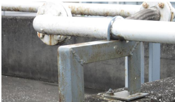
配管のサポート接触部は水が溜まり腐食しやすい
