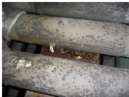
防食措置の劣化がみられる
