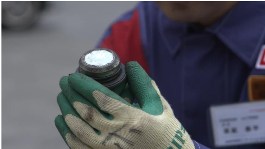
漏洩検査管の蓋の機能を確認。
