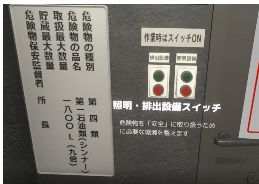
図－２９ 照明設備及び排出設備のスイッチ
