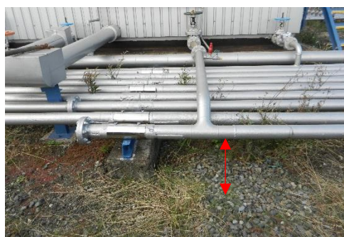
地面との離隔がない例
