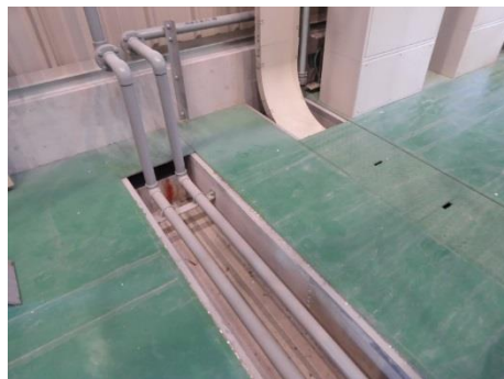
配管ピット（屋内）
