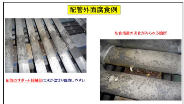
図－ 7 配管の外面腐食の設問に対する解説
