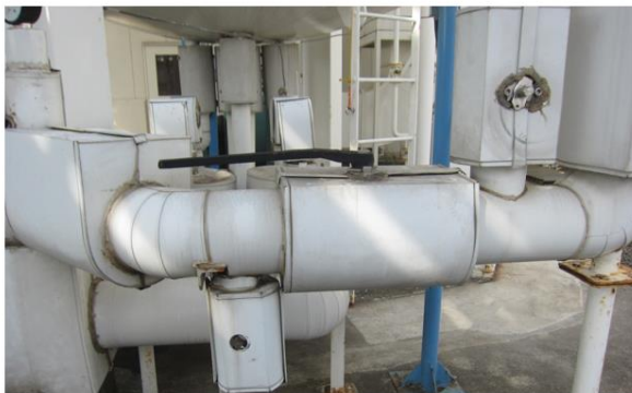
保温材の外装施工がしにくい部位雨水の侵入 ・フランジ、バルブ部
