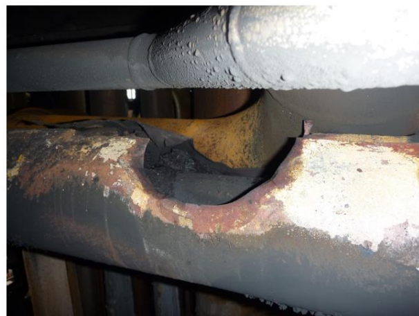
保温材(板金)の切り欠きは雨水侵入
