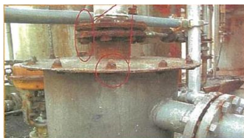
ボルトナットの腐食が進行しスパナが掛らない例
