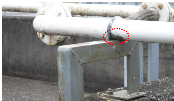
サポート接触部は水が溜まり腐食しやすい
