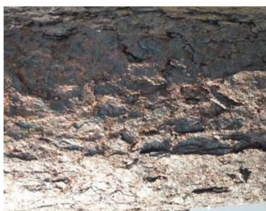
保温材を剥がした配管写真 (かさぶた状に錆びている)
