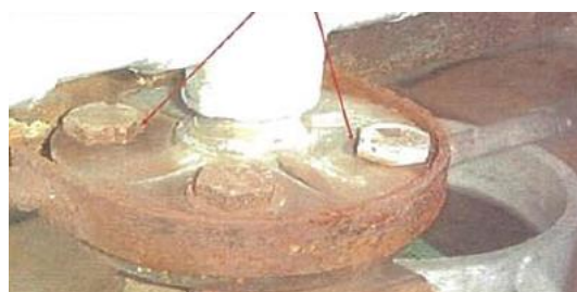
ワッシャー座金不足の例
