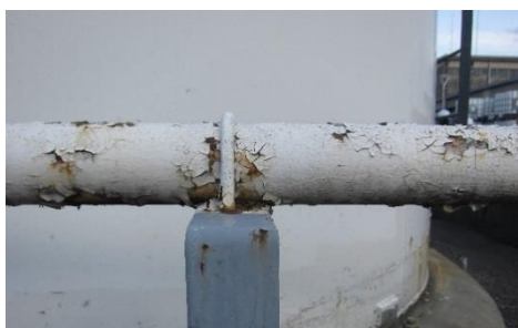
塗装のふくれの例
