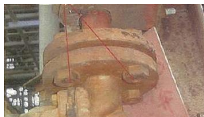
ボルトの長さ不足の例
