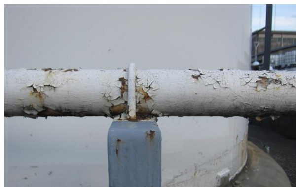
Uボルト(バンド)は腐食しやすい
