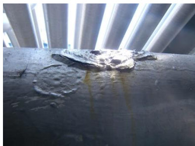
上部から雨水が垂れ腐食した例
