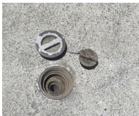
実際の漏えい検査管
