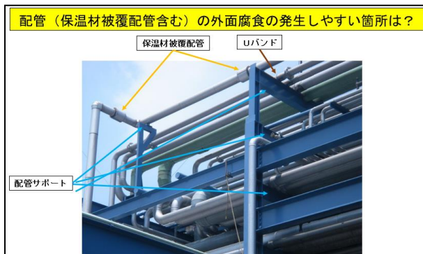
図－ 6 配管の外面腐食の設問
