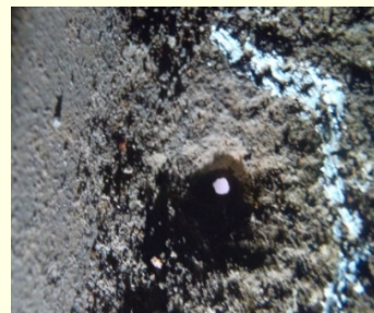
(1-1) 内面腐食穿孔
