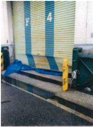
シャッターの破損
