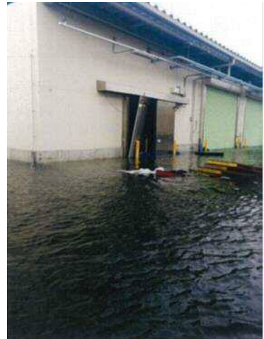
定温倉庫のシャッター破損
