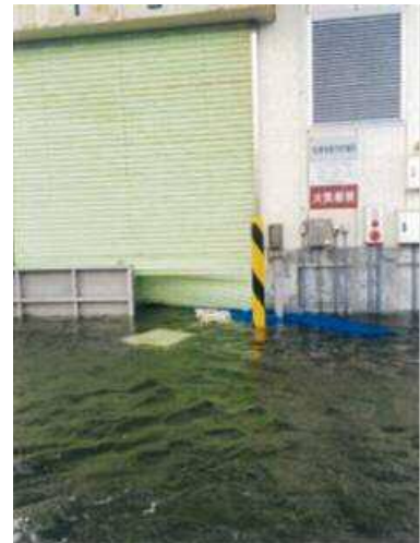
シャッターの破損
