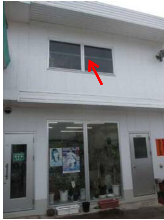
事務所の浸水高さ表示
