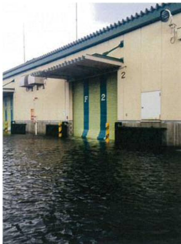
シャッターの破損
