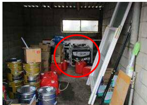
自家発電設備を更新
