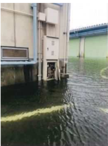
配電盤の破損
