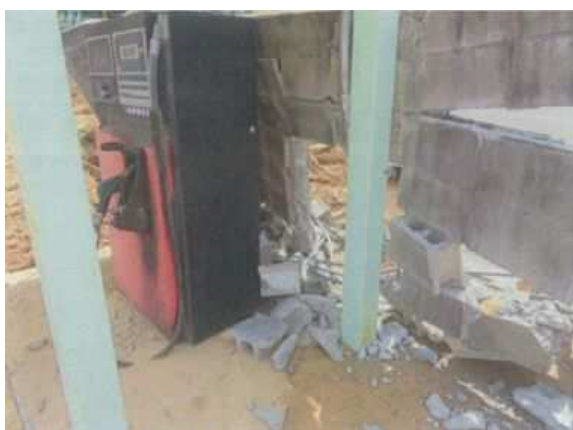
自家用給油取扱所の防火塼破損状況
