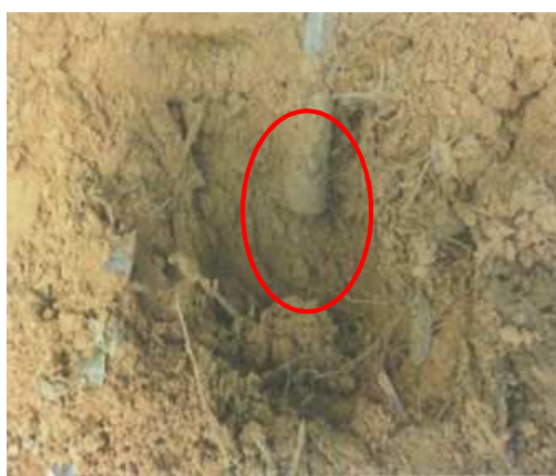
自家用給油取扱所の通気管破損状況
