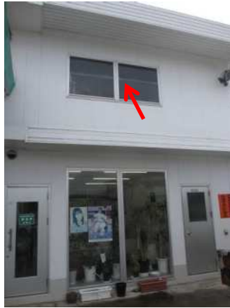
事務所の浸水高さ表示
