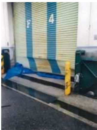
シャッターの破損
