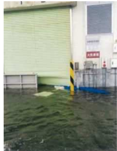
シャッターの破損
