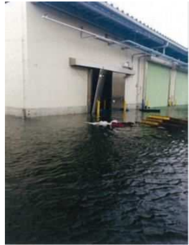
定温倉庫のシャッター破損
