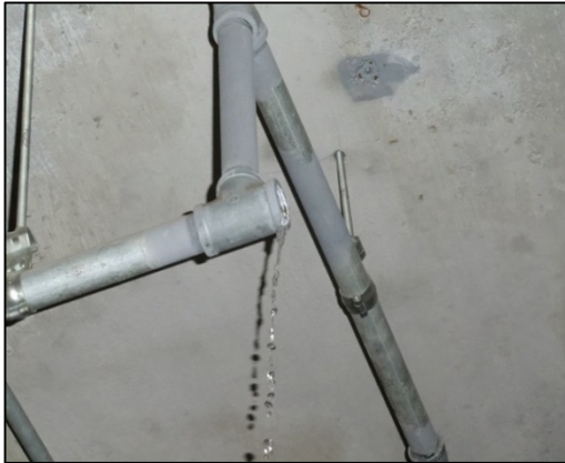
液抜きしている例（泡水溶液が切れるまで3～8時間）
