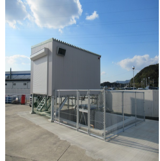
○排水ポンプ場
