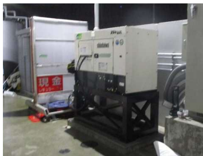
非常用発電機
