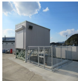
排水用ポンプ設備
