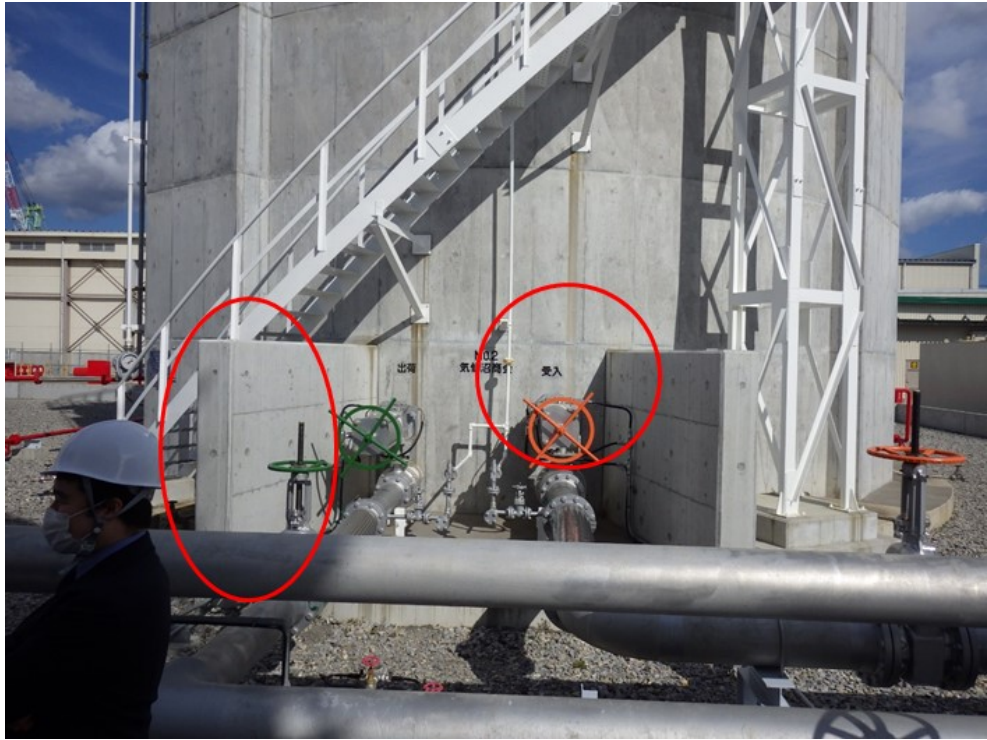
図 2-24 タンクノズル部の防護壁と緊急遮断弁
