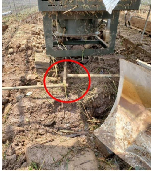
図 2-19 破損した配管
