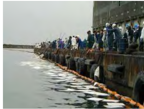
写真8-8-6 マット状吸着材の誤った使用例
