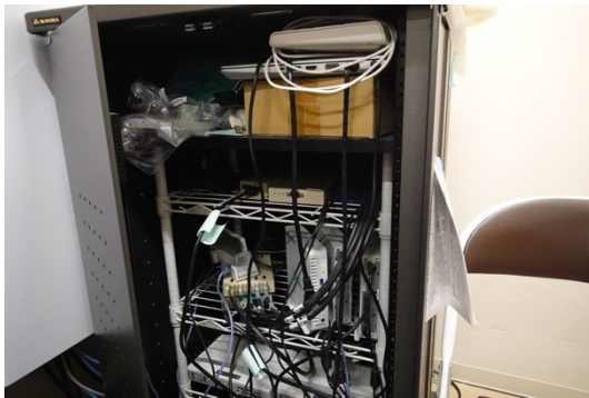
写真 3 既存サイネージ制御装置
