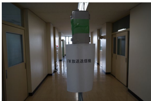
写真 19 廊下に設置してミニ FM 放送装置
