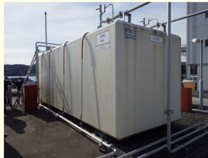
宮城県志津川漁港に設置されたコンクリート被覆型タンク
