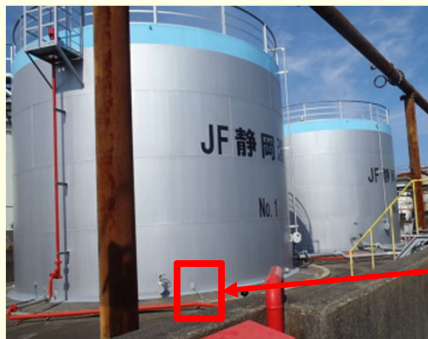
静岡県清水港に設置された、ターンバックルで固定したタンク
