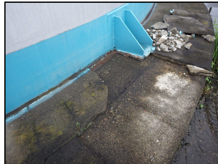
基礎のひび割れ、欠損
