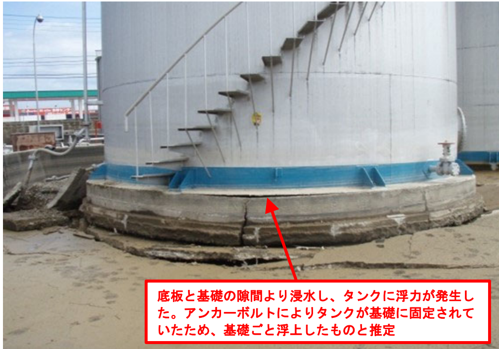
図 2-35 No. 3 タンク 被害状況
