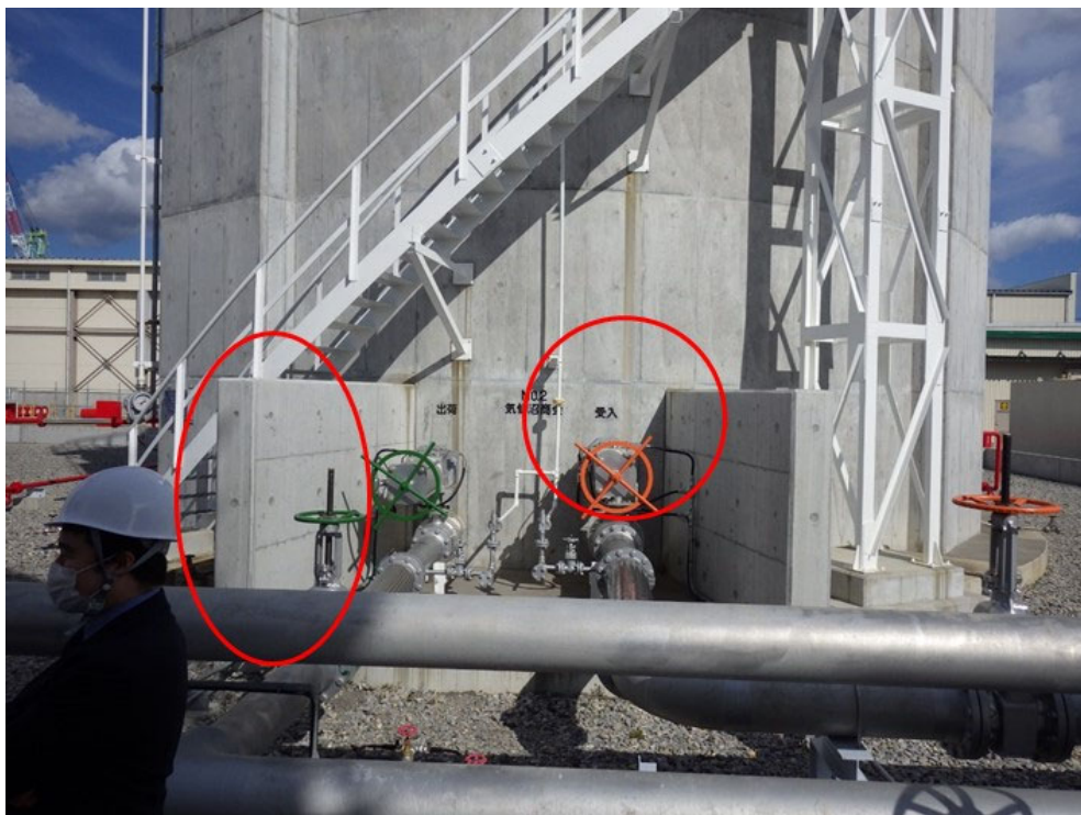
図 2 -15 タンクノズル部の防護壁と緊急遮断弁
