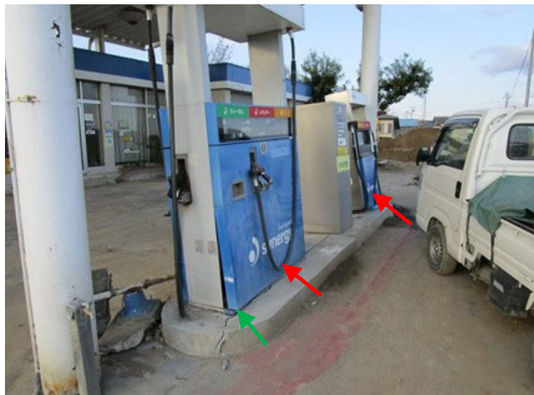
図 2 - 40 N給油所 計量器の傾き（赤矢印部）と基礎の割れ（緑矢印部）
