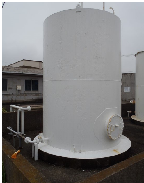
図 3－18 小型屋外貯蔵タンクの例
