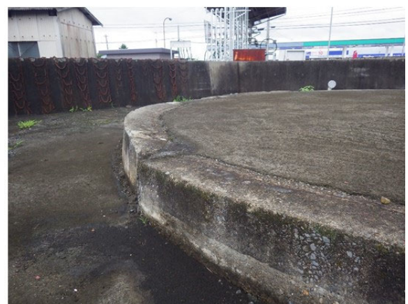
図 2-34 No. 3 タンク リング基礎割れ部拡大
