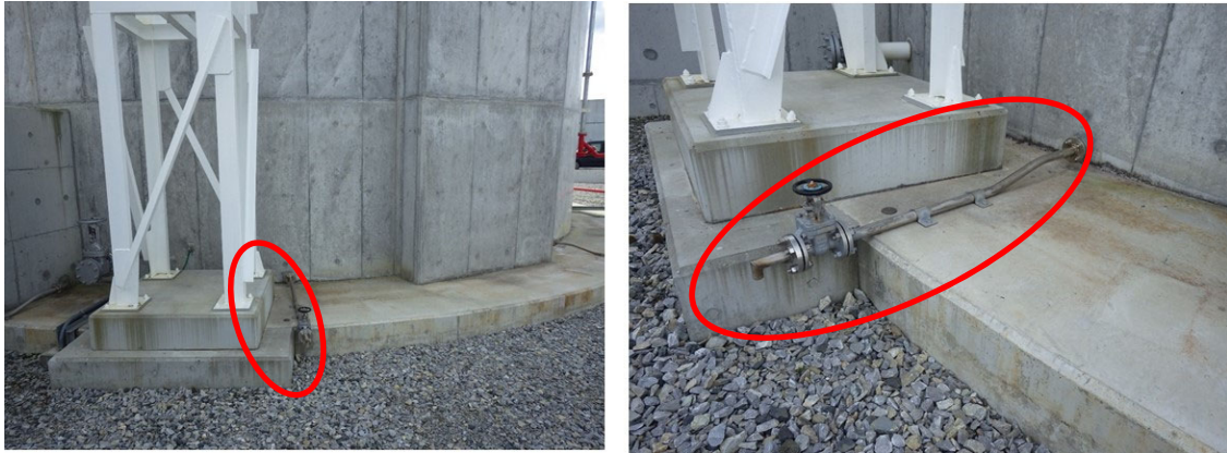
図 2 -14 タンクと P C 壁間の排水管とバルブ
