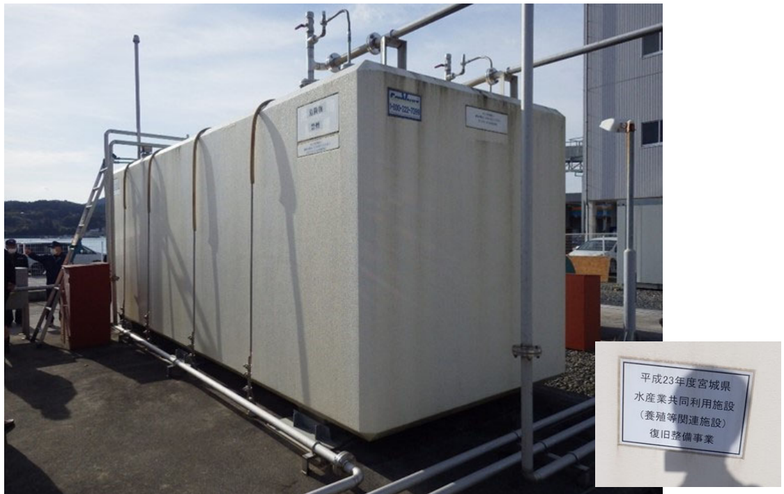
図2-16 志津川漁港 コンクリート被覆型タンク
