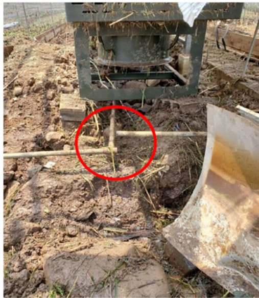
図 2-9 破損した配管
