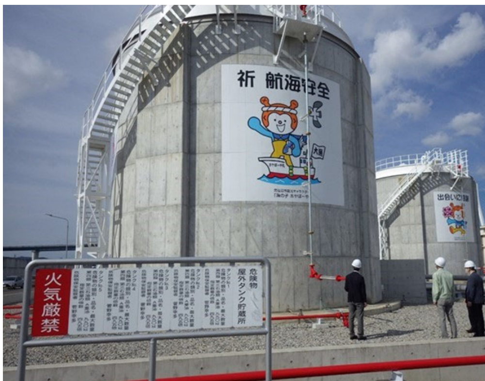
図 2-12 気仙沼市 P C 工法 津波対応型準特定屋外貯蔵タンク
