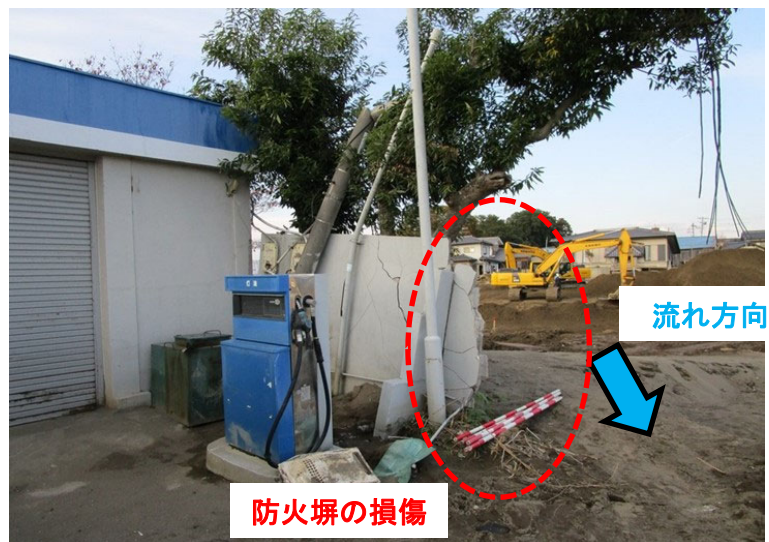
図 2 - 41 N給油所 防火塼の損傷 1
