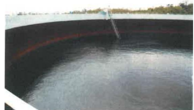
浮き屋根の沈下の状況 8
