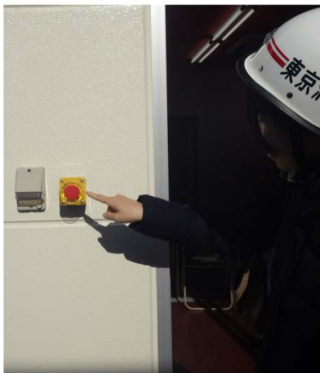
事務所の出入口付近の壁に設置した例
