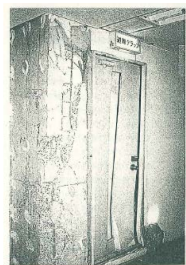
写真10 扉外周枠の変形による 開放不良の例
