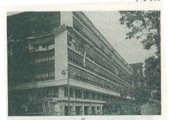
写真2 8層建物：6層崩壊
