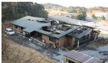
火災発生後の外観
